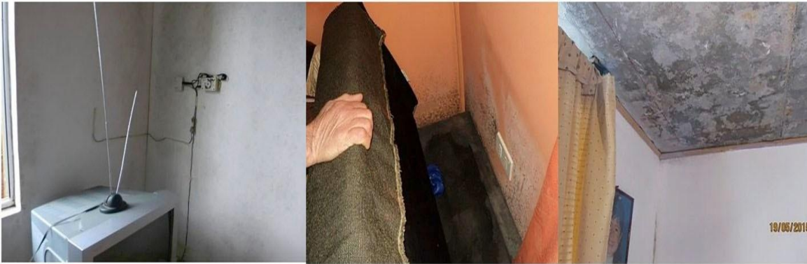
圖 3 智利案例之建築損害
