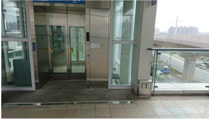
圖 18 淡海輕軌電梯周邊設置截水溝排水
