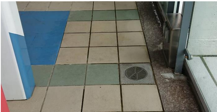
圖 19 淡海輕軌人行通道設置落水頭排水
