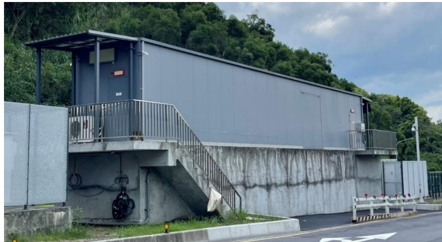
圖4-安坑輕軌之貨櫃型牽引動力變電站
