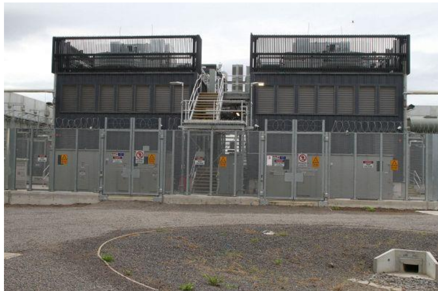
圖7-北墨爾本地鐵主變電站外觀圖
