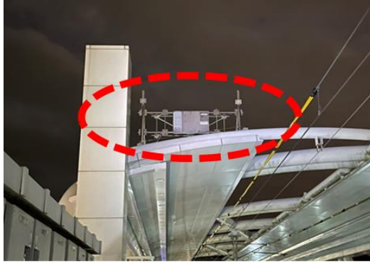
圖 9 V07無線電系統實際安裝情形
