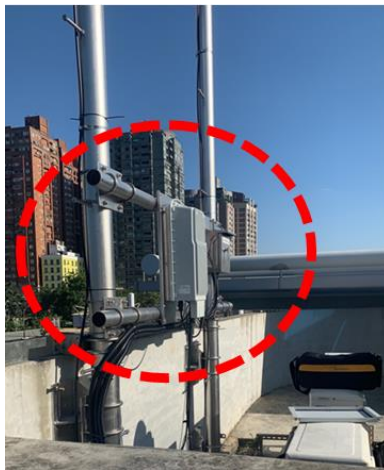
圖 10 V26無線電系統實際安裝情形
