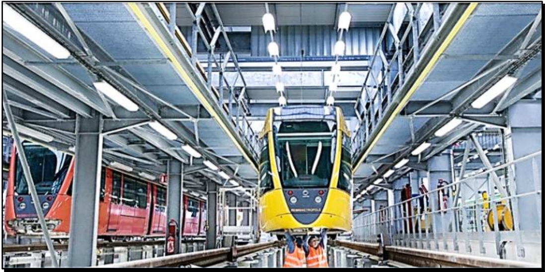
圖 23 單一立柱型式檢修平台
