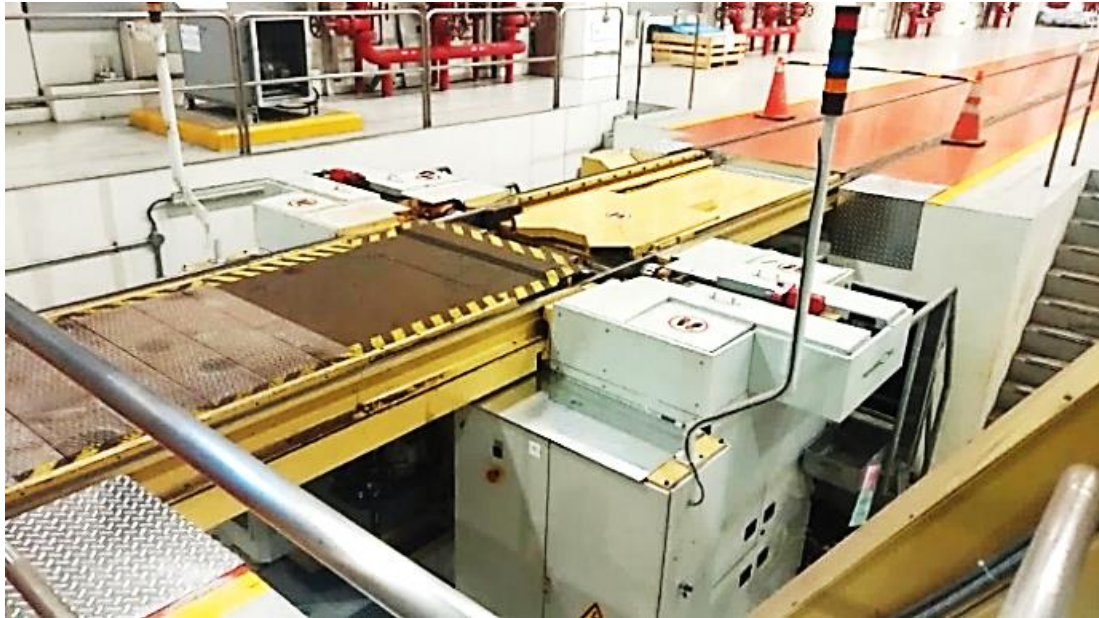
圖 17 地下式自動車輪車床設備
