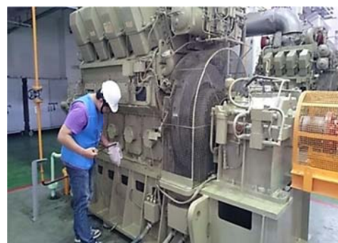
抽水機操作作業
